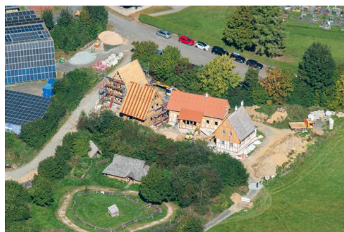
Das Naturdorf Bärnau ist ein Bauprojekt neben dem Geschichtspark Bärnau-Tachov, einem authentischen Freilichtmuseum in Bärnau im oberpfälzischen Landkreis Tirschenreuth. Hier entstehen derzeit vier komplett ökologisch gefertigte und klimaneutrale Ferienhäuser. Foto: djd/Via Carolina Naturdorf/Rene Muehlmeier
